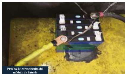
Prueba de cortocircuito del módulo de batería
